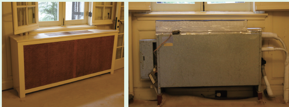
▲ 故居大修后的空调
